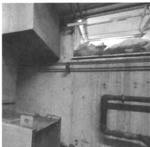
Les prises d'air de la cour anglaise sont remplies de débris...
