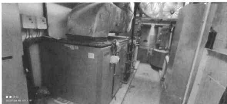
Le local technique regroupe les centrales de production de froid. Une cour Anglaise amène de l'air (de manière insuffisante) Après construction, Des condenseurs ont été installé à l'extérieur, afin de diminuer la température du local et améliorer le fonctionnement. En revanche, en cas de forte chaleur, il faut laisser la porte du local ouverte (afin d'éviter les pannes). Prise d'air au rez du sol....
