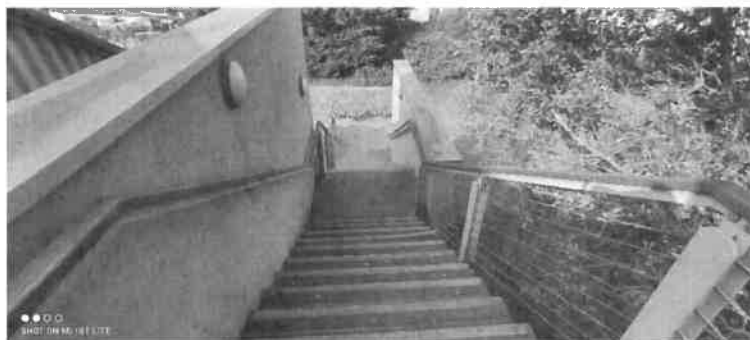
Le personnel accède aux vestiaires via un escalier par l'extérieur. (Non PMR) Attention aux marches abimées.
