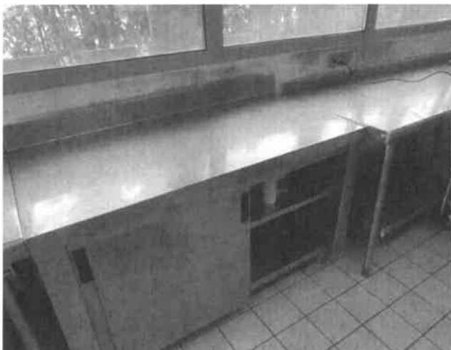
Panneaux avec des traces d'usures et/ou détériorés.
