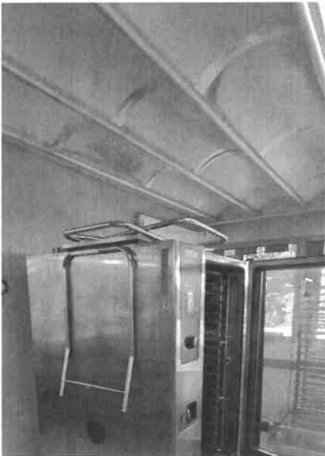
Le plafond filtrant présente de nombreuses fuites. Il est à remplacer
