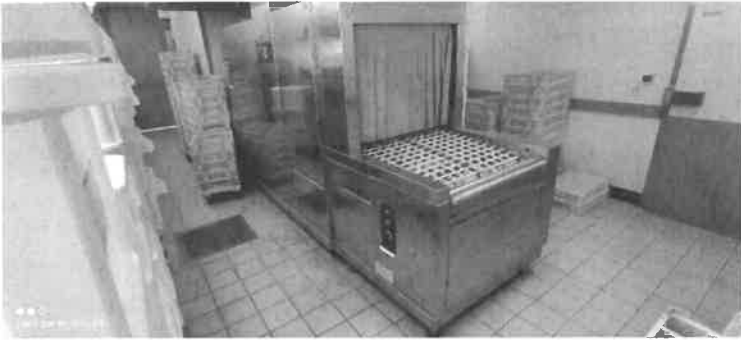
Le local retour plonge batterie est trop petit.
