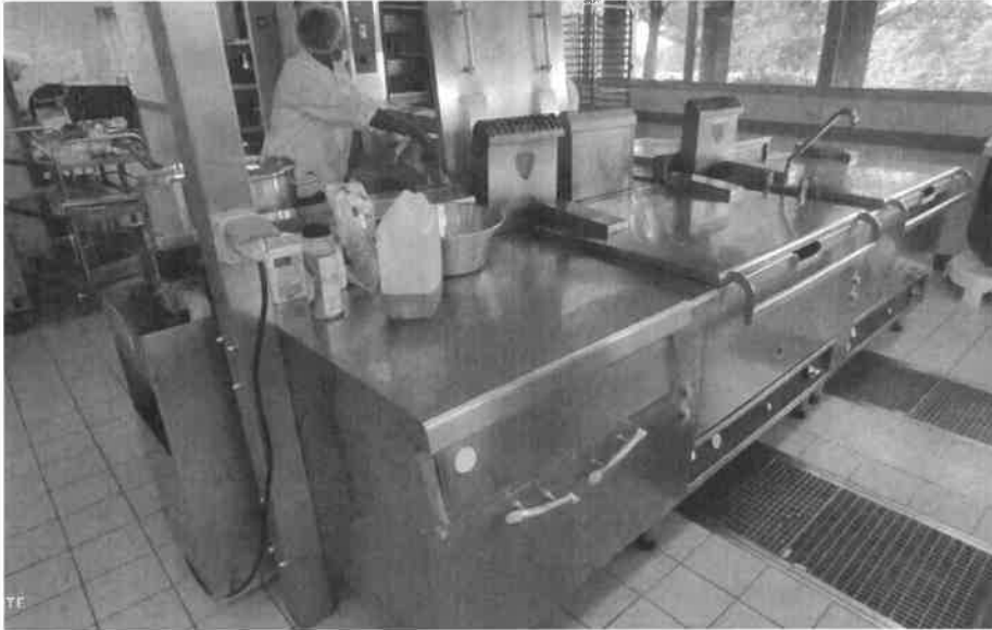
Le piano de cuisson est hétéroclite et est limité en capacité de production.
