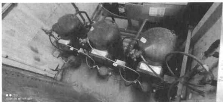
Les centrales ont 15 ans, vérifier la conformité des gaz. En effet, la réglementation des gaz ont changé.
